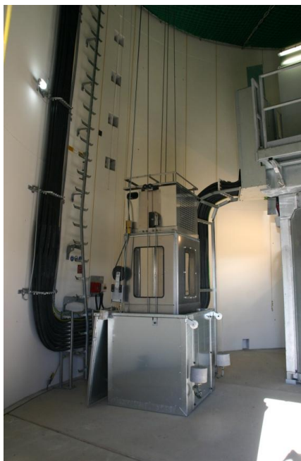
(Aufzug im Turm der Windkraftanlage)
